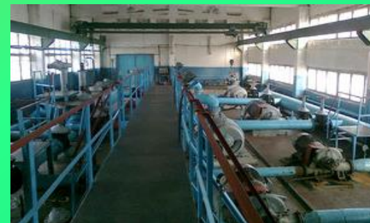
Таврический групповой водопровод ОАО «Омскоблводопровод»
