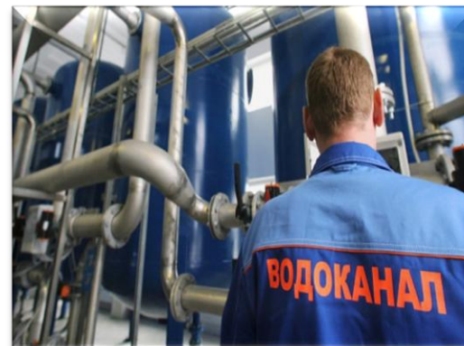
МУП Кормиловский «Водоканал» Обеспечивает район водоснабжением и водоотведением
