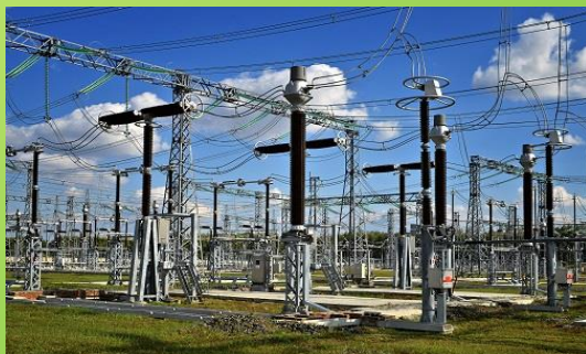
Филиал ПАО «МРСК Сибирь» - «Омскэнерго» Таврический РЭС
